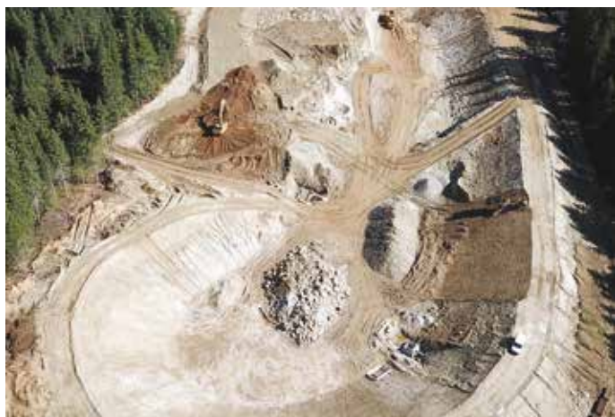
8A e 8B. La preparazione della pista da sci lunga 6 km (8A). In basso a destra, la fase iniziale di rivestimento delle sponde del bacino con geotessili (8B)
