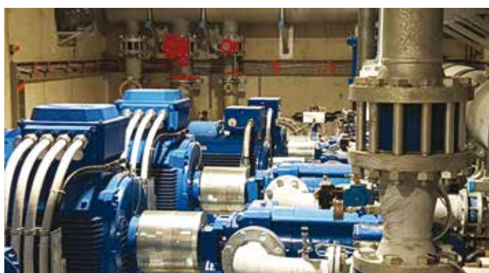
4. La stazione di pompaggio di aria e acqua
